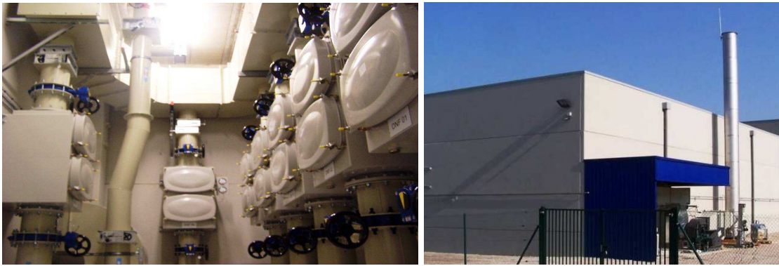
Figure 7 : Les 7 lignes de doubles filtres THE des bâtiments 3 & 4, et la cheminée des bâtiments 3, 4 & 5
