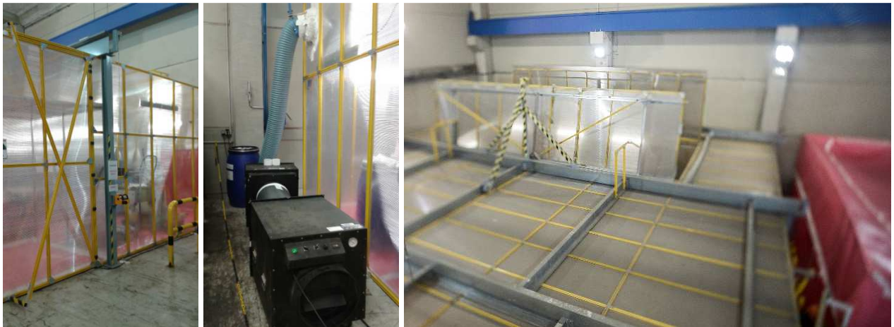
Figures 10 : Sas autonome SET-GV en hall d'entreposage, façade, groupe filtration THE & toit ouvrant
