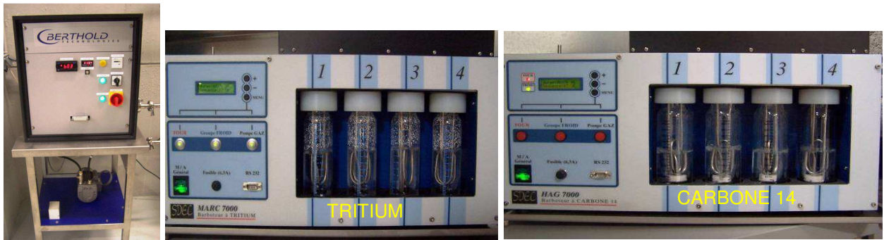
Figure 9 : Préleveur d'aérosols & d'iode 129, barboteur tritium, et barboteur pour carbone 14. Prélèvements dans les effluents gazeux après les filtres THE & avant le rejet à la cheminée
