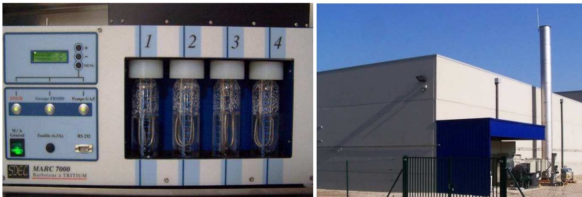
Figures 24 : Prélèvements et rejets des effluents gazeux d'installations Barboteurs de prélèvement du tritium, & ventilateur et cheminée de rejets des effluents après filtration
